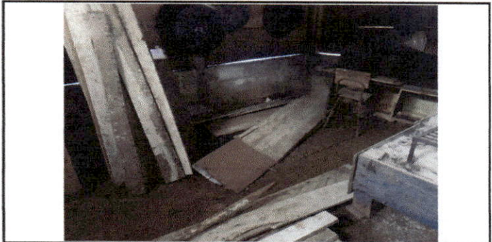
Foto 10: Cocina sin estufa adecuada para preparación de alimentos.
