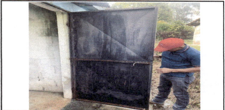
Foto 8: Puertas oxidadas y en condición depreciable.
