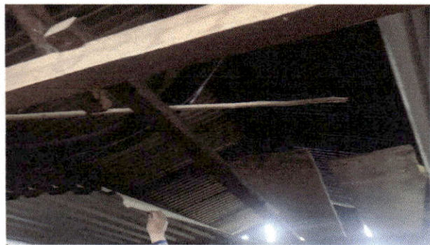
Foto 3: estructura y lamina en cocina en muy malas condiciones.
