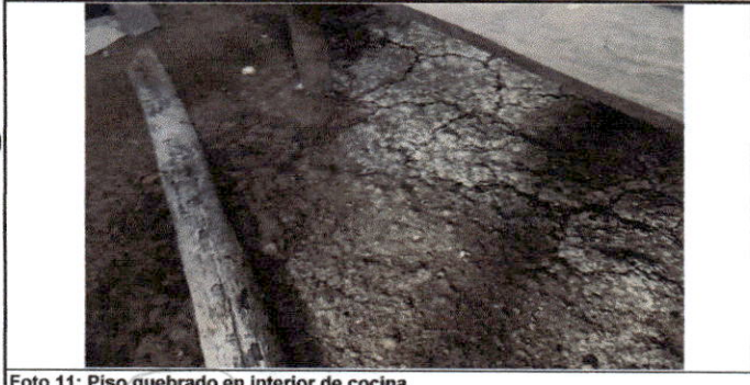
Foto 11: Piso quebrado en interior de cocina.
