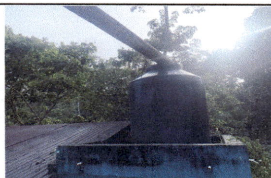
Foto 4: Estructura de tanque de agua en mal estado por humedad
